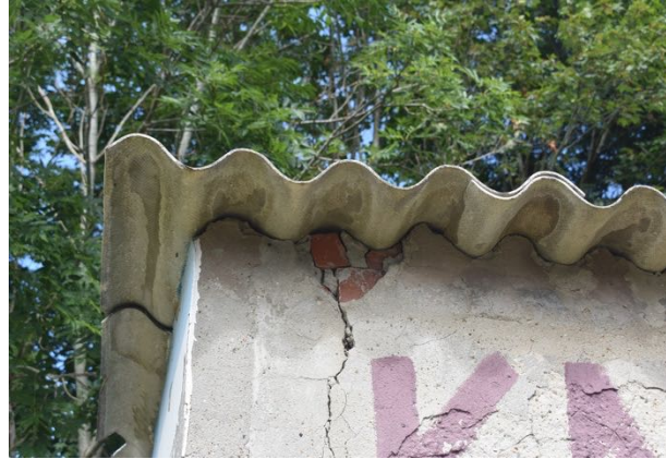
5b. Blick unter die Wellplatten mit kleinen Lücken und Rissen im Mauerwerk
