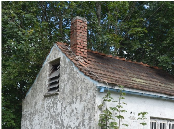
3c. Einflugmöglichkeit zum Dachstuhl und sich lösende Schindeln am Dach
