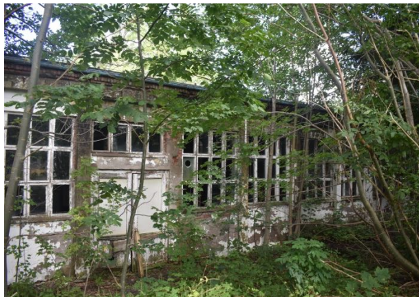
2b. Rückseite des Gebäudes mit offenen Fenstern und fehlenden Ziegeln, sowie Rissen im Mauerwerk
