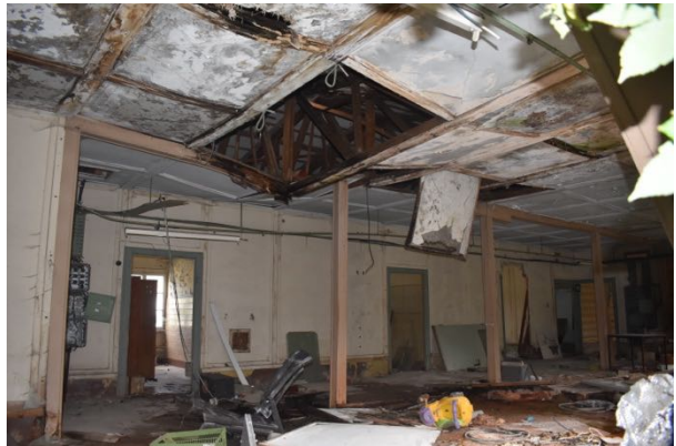
6d. Innenansicht mit zerfallenen Deckenstrukturen
