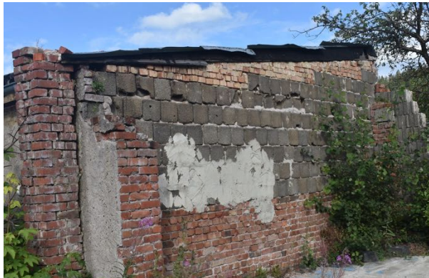
8c. Außenansicht südliches Ende, Blickrichtung Norden mit offenen Hohlsteinen und offenen Fugen
