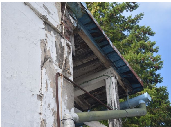
2c. Fehlende Holzlatten in der Vordachverkleidung und Risse im Mauerwerk
