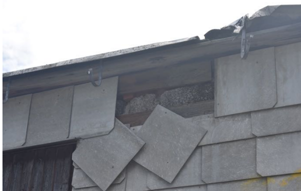
7e. Sich lösende Schindeln außen
