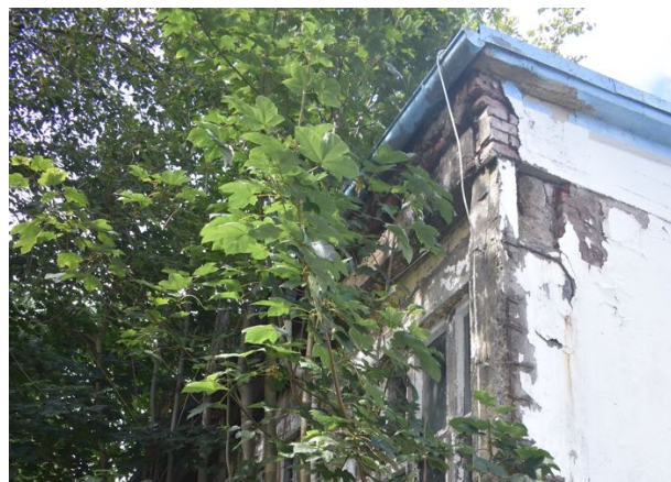
2d. Offene Fugen zwischen den Ziegeln, leicht abstehende Attika und Risse im Mauerwerk an der Rückseite des Gebäudes
